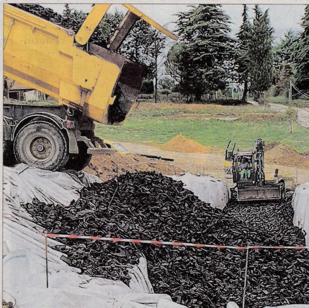
Selon l'assistant du maître d'ouvrage, les pneus déversés dans les bassins seront extraits dans les prochains jours. Photo Le DL/J. C.
